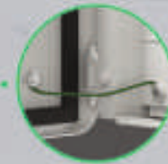
Door Earthing Cable
